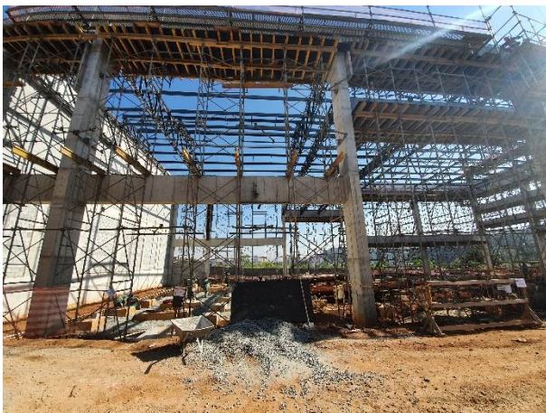
Obra Civil – execução dos pilares, vigas e cobertura metálica da sala Elétrica.
