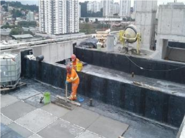
Acesso Heitor dos Prazeres - impermeabilização da laje de cobertura das Salas Técnicas.
