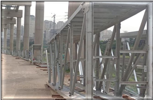
Vias do Monotrilho/Civil – instalação da passarela de emergência no trecho Chucri Zaidan - Morumbi.
