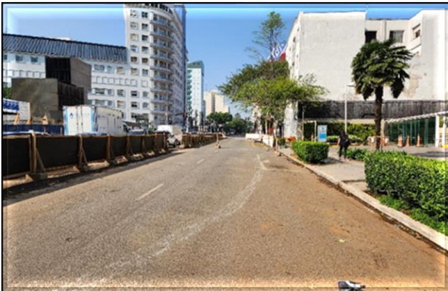
Em operação a primeira fase do desvio de tráfego da Avenida da Liberdade/Rua Vergueiro.
