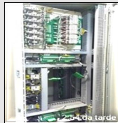
Gabinete de terminação de cabos
