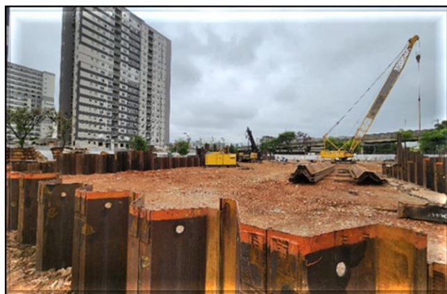
Obra Civil – cravação das estacas prancha de contenção do corpo da estação.
