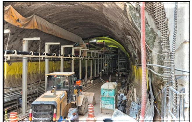
Vista das utilidades da tuneladora no túnel de transição da VSE Coxim.
