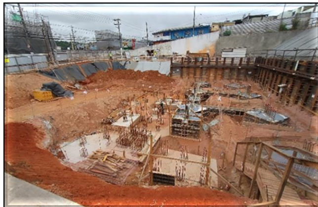
Obra Civil – execução dos blocos de fundação e vigas baldrame do Edifício Técnico Operacional (ETO).
