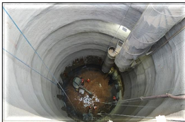
Local do poço de escavação do túnel: escavação e revestimento primário concluídos (31,50m escavados).
