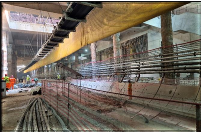
Vista das utilidades da tuneladora na Estação Anália Franco.
