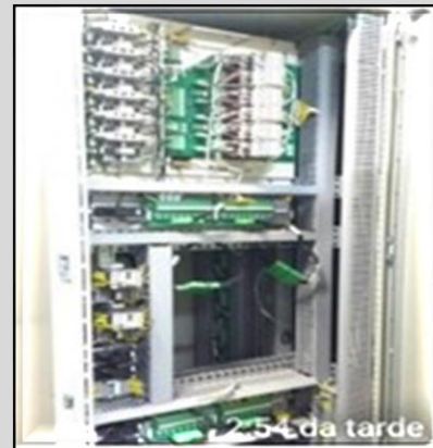
Gabinete de terminação de cabos
