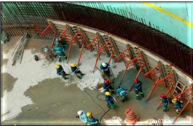
Impermeabilização e parede do revestimento secundário do poço do corpo da estação.
