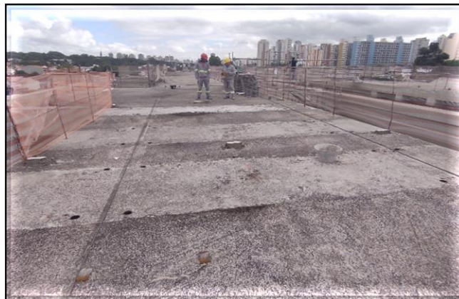
Corpo da estação/Obra Civil – Início das atividades para execução do piso de granito na plataforma.
