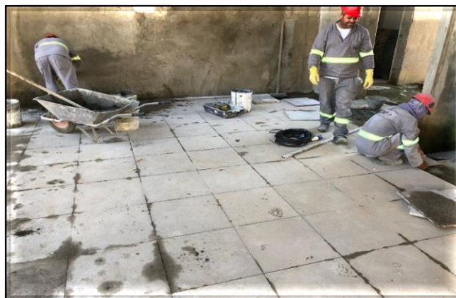
Acesso A/Obra civil – Execução dos arremates do piso de granito do hall.
