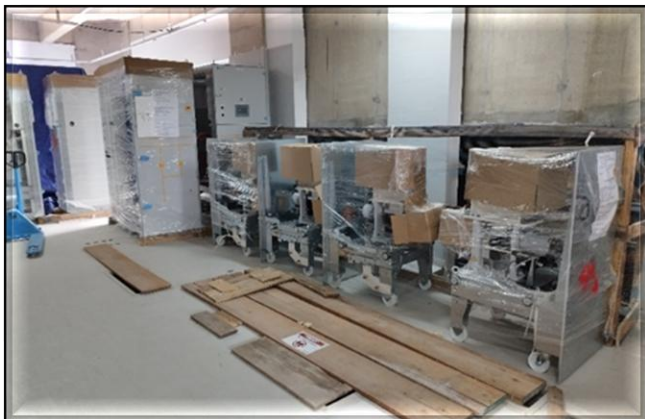
Sistemas — instalação dos cubículos de tração e de média tensão nas salas técnicas
