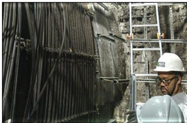
Sistemas: remanejamento de cabos de tração, média tensão, telecomunicações e sinalização na Via 2 da Linha 2 – Verde, na região do túnel sul.
