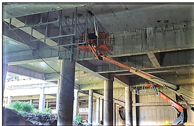
Sistemas - caminhamento de cabos (bandejamento) sob a laje do pisciño.
