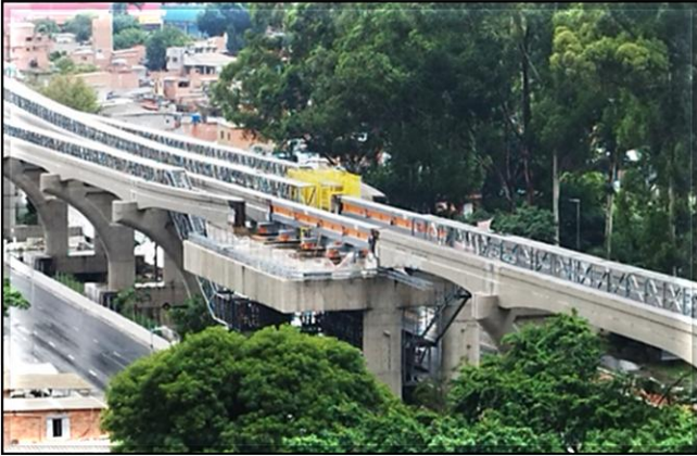
Sistemas – Aparelho de Mudança de Via X-25 posicionado entre as estações Washington Luís e Brooklin Paulista.
