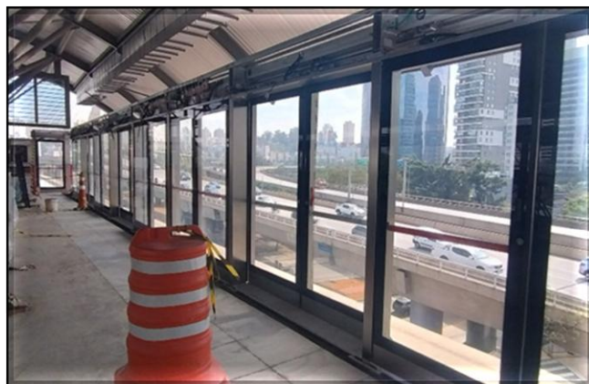
Sistemas – instalação elétrica das Portas de Plataforma
