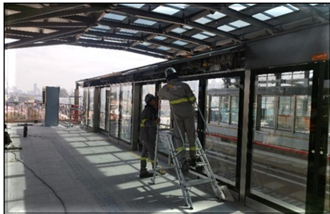
Sistemas – instalação elétrica das Portas de Plataforma.
