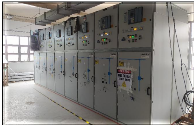
Sistemas – cubículos de média tensão energizados nas Salas Técnicas.
