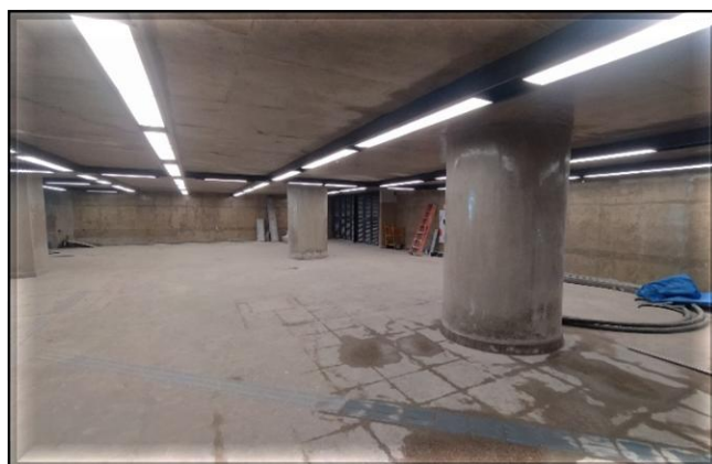
Sistemas – iluminação instalada na região de interligação com a Linha 5 - Lilás
