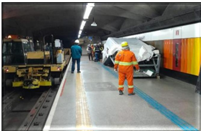
Escada Rolante 24: Chegada e armazenamento.
