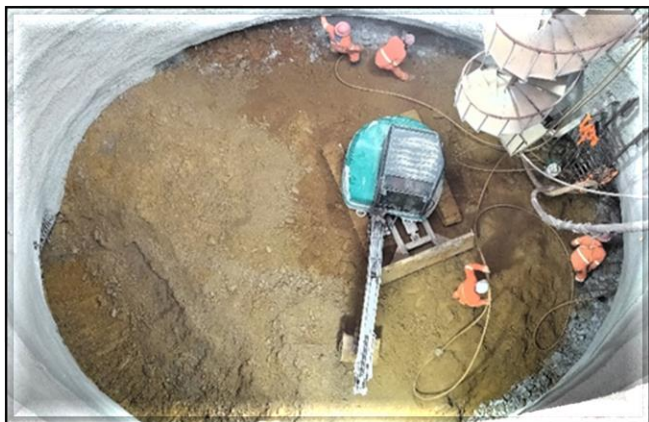
Local do poço de escavação do túnel: escavação e revestimento primário em execução. 17,2m de 31,5m escavados.
