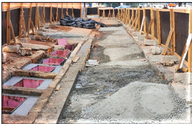
Remanejamento de interferências da pista sentido centro da Avenida da Liberdade para implantação do desvio de tráfego.
