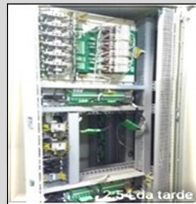
Gabinete de terminação de cabos
