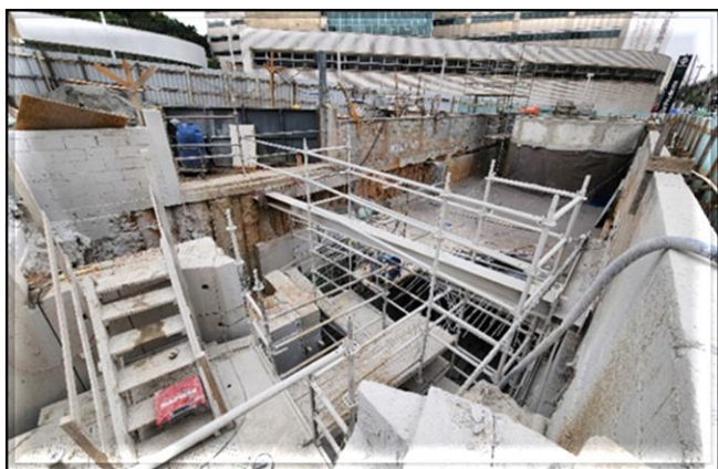
Exaustão 1 - Novo canal de ventilação da Plataforma 2 da estação Vila Prudente da Linha 2-Verde.
