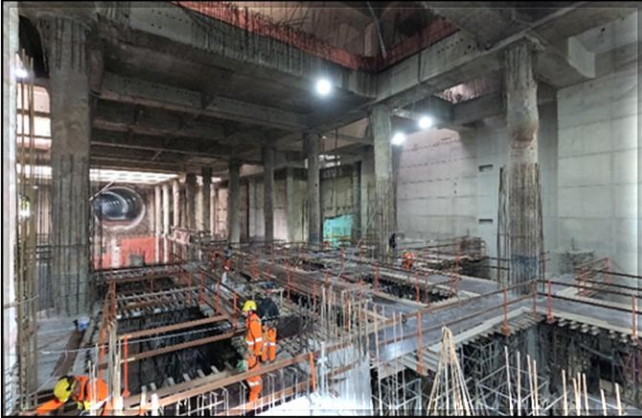
Estruturas internas e pilares em execução no corpo da estação – plataformas da Linha 2 – Verde.
