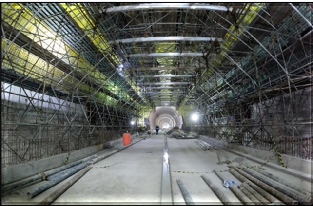
Formas, armações e concretagem do revestimento secundário do corpo da estação, e concretagem da laje de via.
