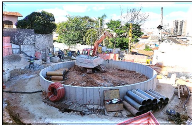
Viga de borda executada e instalação dos equipamentos de rebaixamento do lençol freático.
