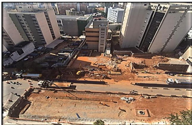
Início da escavação da área de integração entre o novo Acesso Leste e a estação
