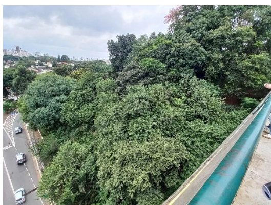
Foto 9.7-1 – Talude próximo a estação Sumaré onde pode haver risco de instabilidade em razão do empreendimento.
