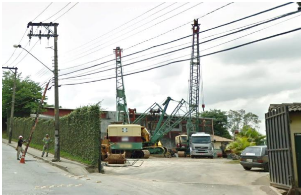
Foto 49 – Vista geral da H. Dardis, em março/2011, ativa.
