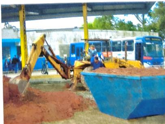
Figura 27 – Remoção de solo contaminado – AC-21 – Viação Raposo Tavares Ltda. (antiga Viação Vidazul Ltda.) – Est. Granja Viana.
