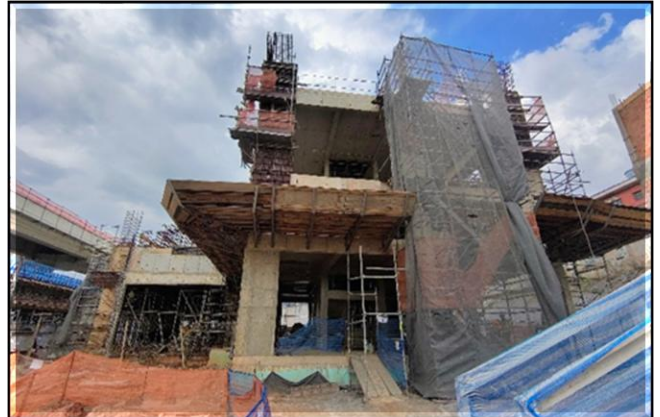
Obra Civil – execução da estrutura de concreto do Acesso Sul e do Edifício Técnico.
