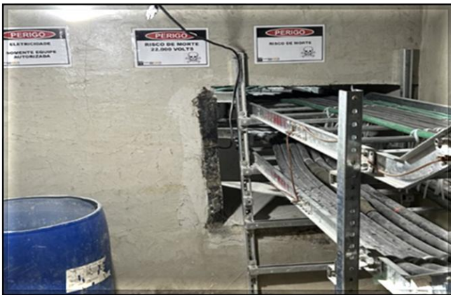
Novo Edifício Técnico Operacional (ETO)/ Porão de cabos: bandejamento.
