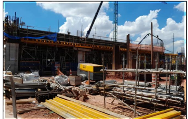
Obra Civil – execução da estrutura das salas técnicas e porão do corpo da estação.
