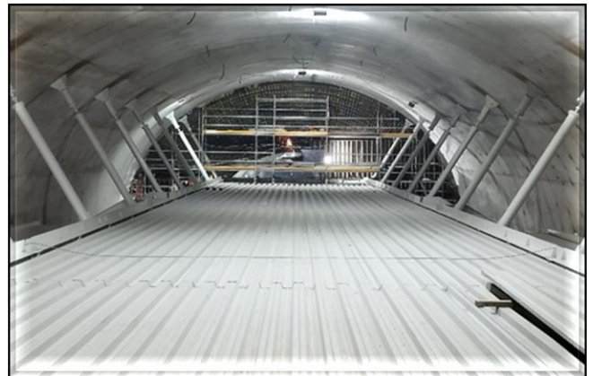
Mezanino metálico e armação da parede do corpo da estação em execução.
