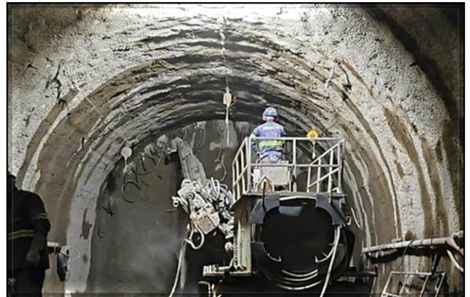
Tratamento do maciço no avanço da cambota em execução, no Túnel direção Sul
