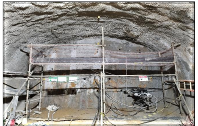
Túnel sul: execução da abertura da parede do túnel de conexão existente.
