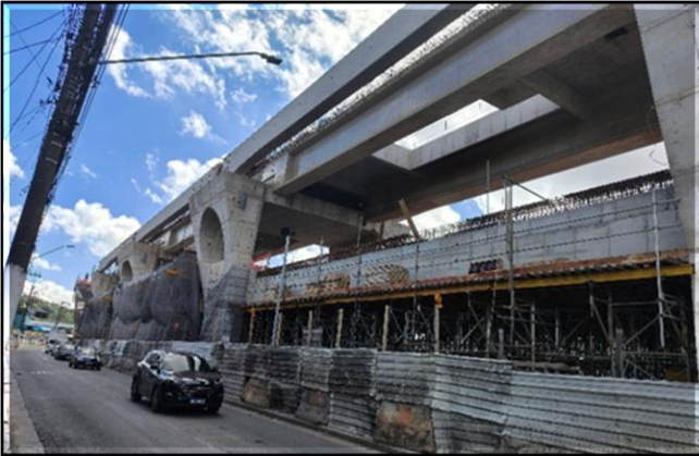
Obra Civil – execução da estrutura de concreto do mezanino do corpo da estação.
