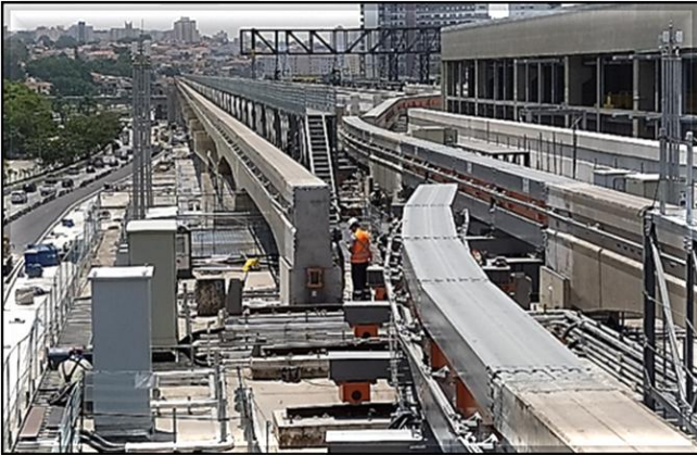
Sistemas – instalação elétrica dos dispositivos de sinalização e de funcionamento do track switch X-23 (após a estação Washington Luís)
