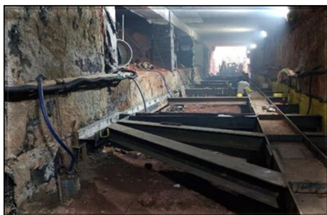
Plataforma/ mezanino lado sul: Impermeabilização e estroncamento metálico sob a laje de cobertura.
