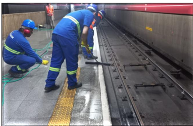
Adequação das estruturas das plataformas para receber a estrutura metálica das PSD's
