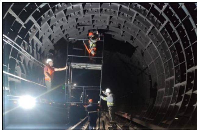
Túnel Via 1: ajustes dos parafusos do revestimento do túnel (preparação para escavação dos Túneis Norte e Sul).
