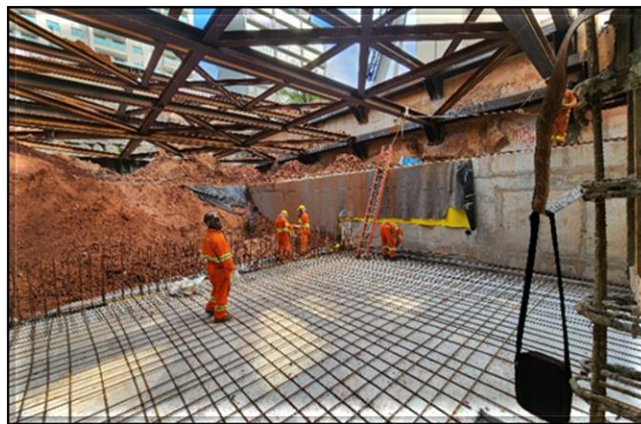
Galeria de Cabos: Em andamento armação do reservatório inferior e reaterro da galeria.
