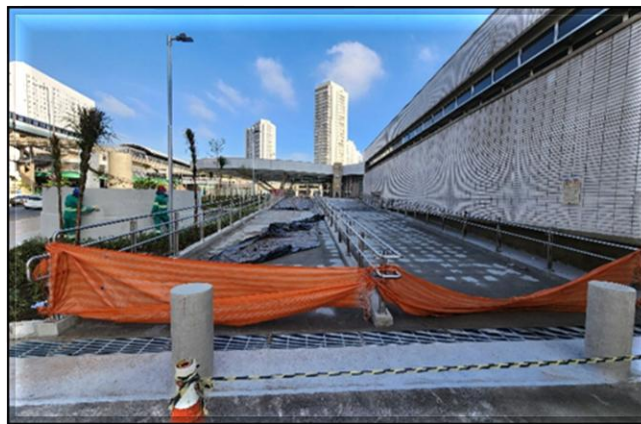
Área externa da estação Vila Prudente da Linha 2-Verde: Recomposição do viário e paisagismo.
