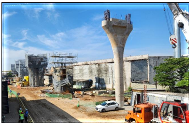
Obra Civil – armação, forma e concretagem dos pilares e capitéis da via elevada.
