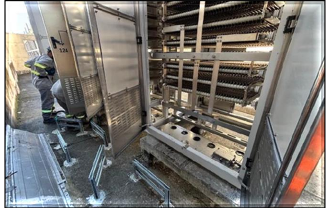
Sistemas – instalação do banco de resistores do AARU (Unidade Automática de Receptividade Assegurada).
