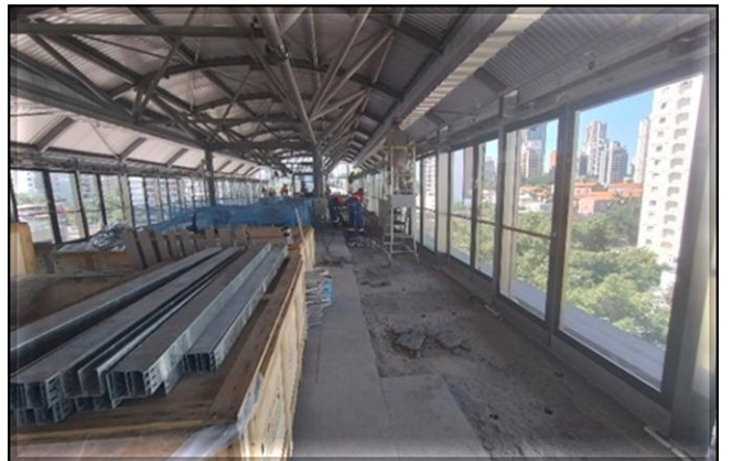
Obra Civil – execução do piso de granito da plataforma. Sistemas – instalação das Portas de Plataforma.
