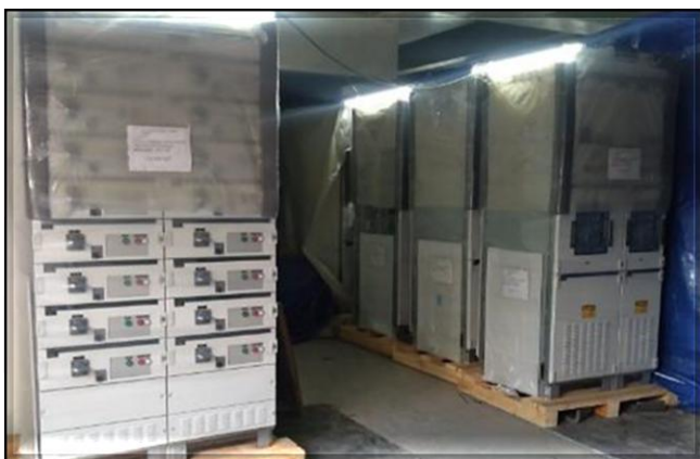
Sistemas — movimentação dos quadros de baixa tensão.
