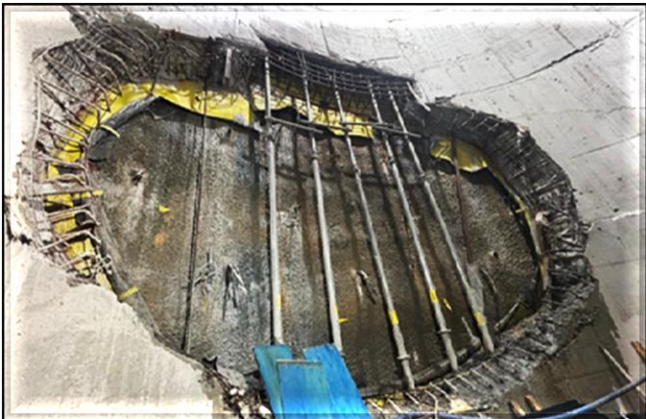
Poço principal: revestimento secundário parcial concluído e vista do emboque do túnel sul (sentido Estação Consolação).
