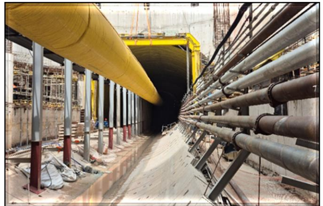
Vista das utilidades na Estação Santa Clara.
