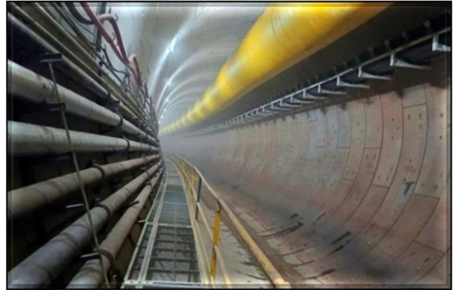
Vista da esteira transportadora de solo e do duto de ventilação do túnel.
