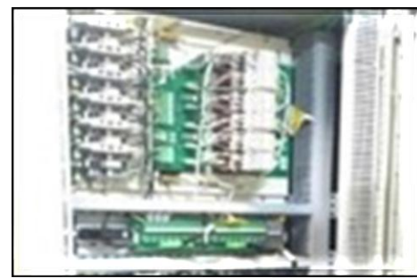
Gabinete de terminação de cabos
