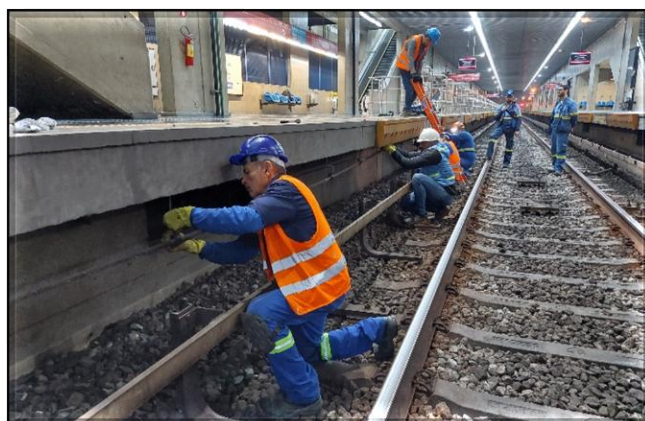
Adequação das estruturas das plataformas para receber a estrutura metálica das PSDs
