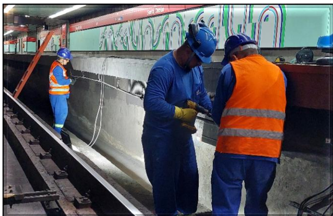
Adequação das estruturas das plataformas para receber a estrutura metálica das PSDs
