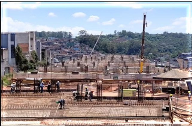
Obra Civil – execução das vigas travessas e deck switch das vias de estacionamento.
