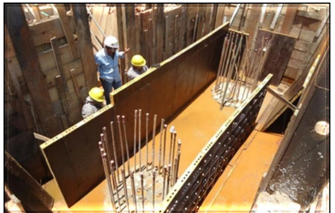
Obra Civil – armação, forma e concretagem dos blocos de fundação da via elevada.
