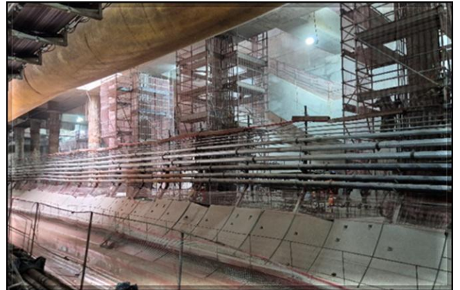
Vista dos segmentos de arraste e esteira transportadora de solo na estação Anália Franco.
