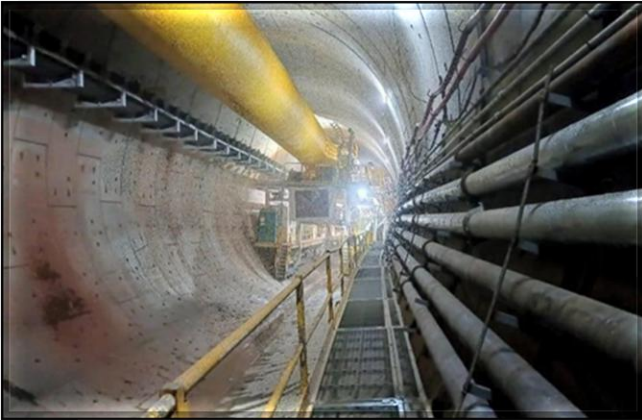
Vista das utilidades e do backup da tunneladora.
