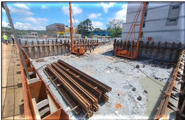
Obra Civil – cravação de perfis metálicos das fundações do Edifício Técnico Operacional (ETO) e Acesso Sul.
