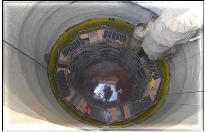
Local do poço de escavação do túnel: escavação e revestimento primário concluídos (31,50m escavados).
