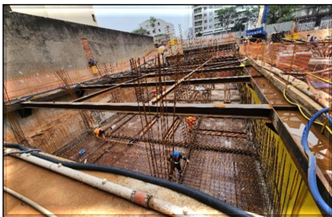
Novo Edifício Técnico Operacional (ETO): paredes do porão de cabos concretadas. Montagem de armação e forma da laje das salas técnicas 1.
