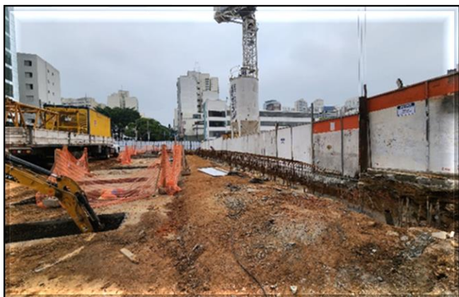
Rua Vergueiro - sentido bairro: armação da viga de coroamento e escavação para as estacas barretes.
