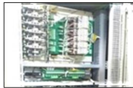
Gabinete de terminação de cabos
