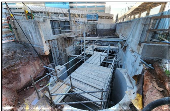
Exaustão 1 - Novo canal de ventilação da Plataforma 2 da estação Vila Prudente da Linha 2-Verde – execução das estruturas do novo canal.
