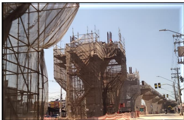
Obra Civil – execução dos capitéis e lançamento das vigas-guia da via elevada
