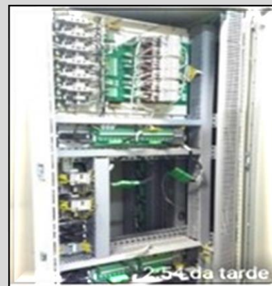
Gabinete de terminação de cabos
