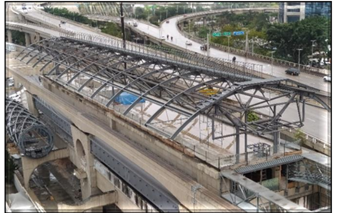
Obra Civil – em andamento a instalação das telhas da cobertura da plataforma
