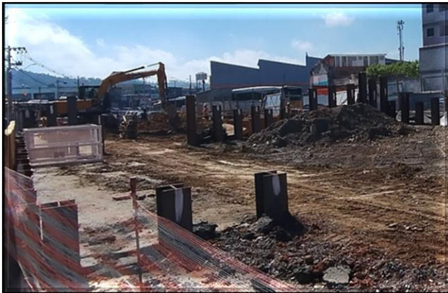
Obra Civil – contenção e escavação para execução dos blocos de fundação do corpo da estação.
