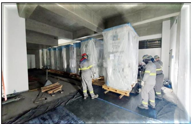
Sistemas – entrega dos cubículos de Média Tensão nas Salas Técnicas.
