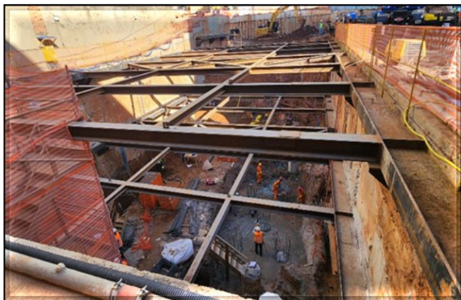
Novo Edifício Técnico Operacional (ETO): escavação e estorcamento da vala e arrasamento das estacas para execução dos blocos de fundação.
