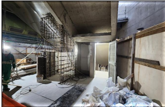
Linha 2-Verde - Plataforma 2 – lado leste – nova escada de acesso ao porão da plataforma.
