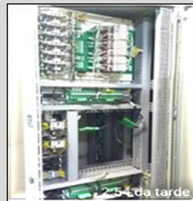
Gabinete de terminação de cabos
