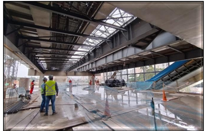
Obra Civil – em andamento a instalação da estrutura metálica do mezanino, da cobertura da plataforma, estrutura de fechamento do corpo e do acesso.
