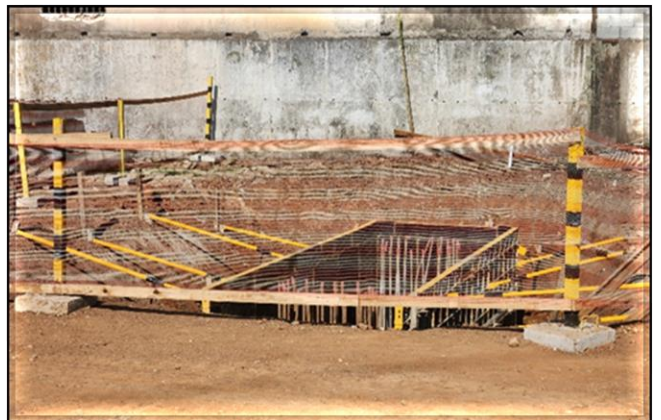
Obra Civil – montagem da armação do bloco de fundação da via elevada.
