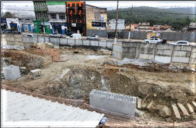
Obra Civil – Em execução do novo sistema de drenagem para o desvio de tráfego.
