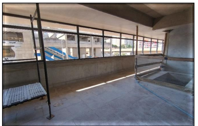
Obra Civil – em andamento a instalação dos caixilhos da Sala de Equipamentos Eletrônicos (SEE) e do Mezanino.
