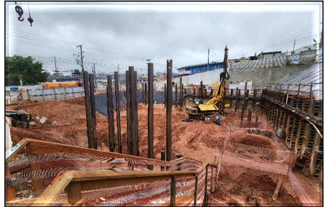
Obra Civil – Em execução as estacas raízes e cravação dos perfis metálicos da fundação do Edifício Técnico Operacional e do Acesso Sul.
