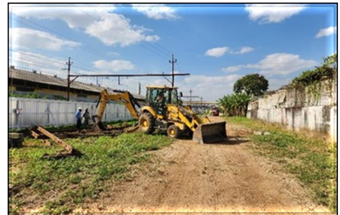
Obra Civil – Remoção de trilhos e dormentes enterrados na área da via elevada.
