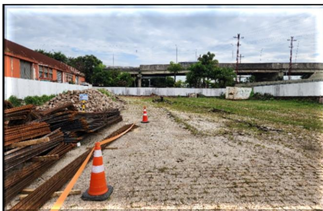
Em andamento instalação de canteiro, limpeza da área e execução de rede de drenagem.
