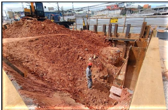
Em execução a contenção e escavação para execução dos blocos de fundação do Corpo da Estação.
