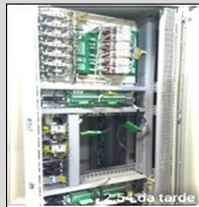
Gabinete de terminação de cabos
