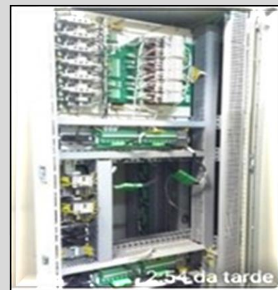
Gabinete de terminação de cabos
