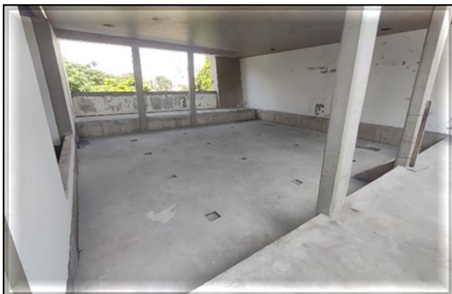
Obra Civil – Em andamento a manutenção do canteiro, limpeza e mobilização das equipes.
