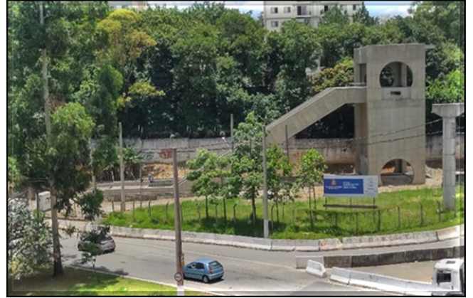
Obra Civil – Em andamento a manutenção do canteiro e mobilização das equipes.
