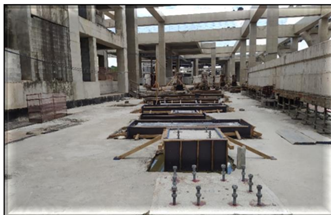
Obra Civil – Em andamento limpeza fina e manutenção de canteiro. | Sistemas – Instalação do bandejamento da galeria de cabos e execução das bases dos aparelhos de mudança de via.
