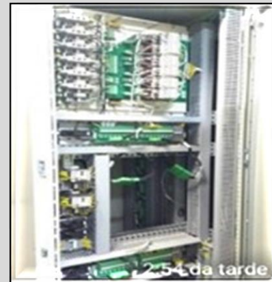
Gabinete de terminação de cabos
