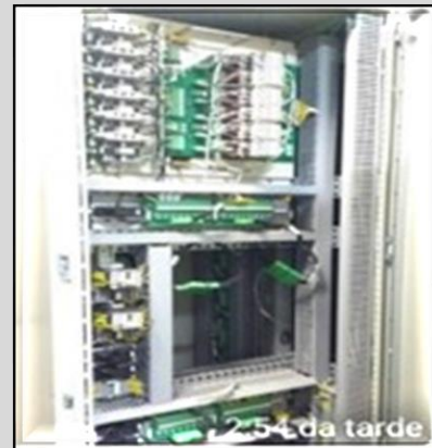
Gabinete de terminação de cabos
