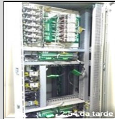
Gabinete de terminação de cabos
