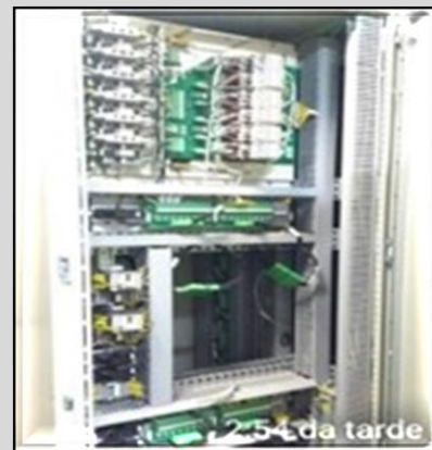
Gabinete de terminação de cabos
