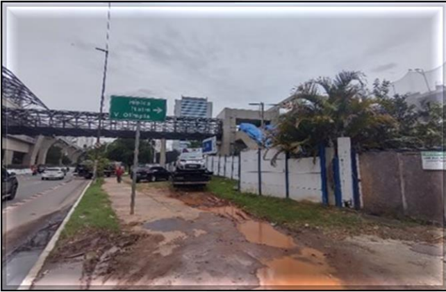
Acesso da Estação/ Obra Civil – Obra civil paralisada. Seis Escadas Rolantes posicionadas.
