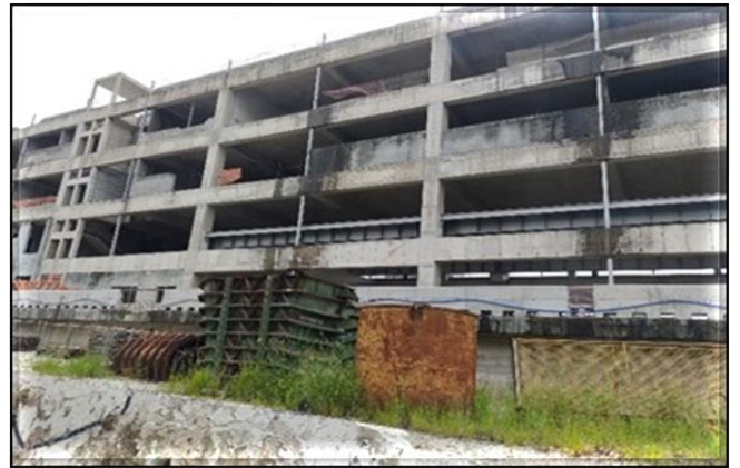
Bloco A/Obra Civil – Obra civil paralisada.
