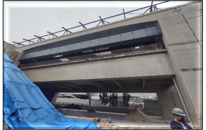
Corpo da Estação/ Obra Civil – Obra civil paralisada. Oito Escadas Rolantes posicionadas.
