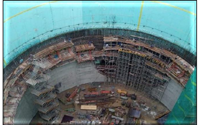
Estrutura de concreto do revestimento secundário do poço do corpo da estação.
