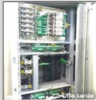
Gabinete de terminação de cabos
