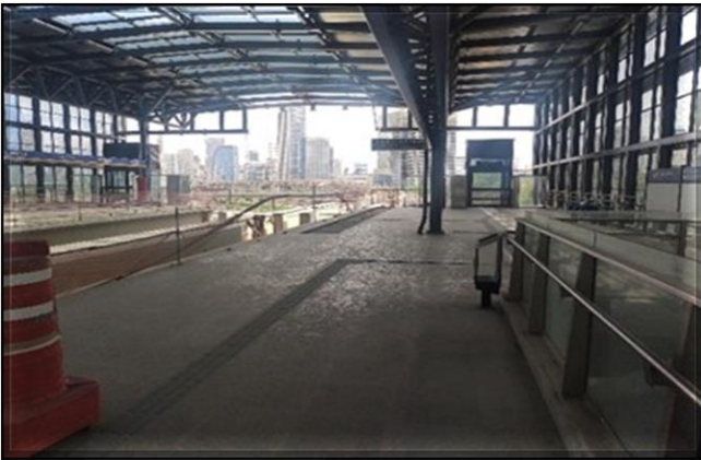
Corpo da Estação/ Obra Civil – Obra civil paralisada. Oito Escadas Rolantes posicionadas.
