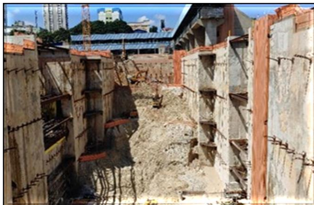
Escavação, tirantes e lastro da laje de fundo da vala do corpo da estação.
