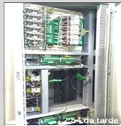
Gabinete de terminação de cabos
