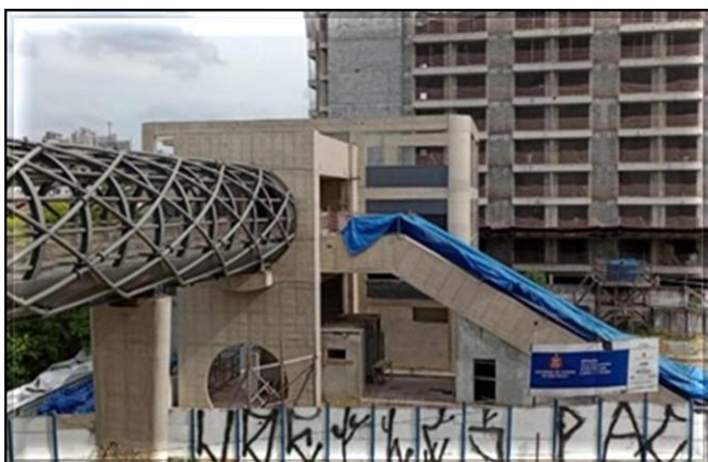
Acesso da Estação/ Obra Civil – Em andamento a contratação direta do escopo remanescente.
