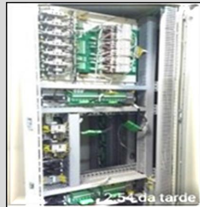
Gabinete de terminação de cabos
