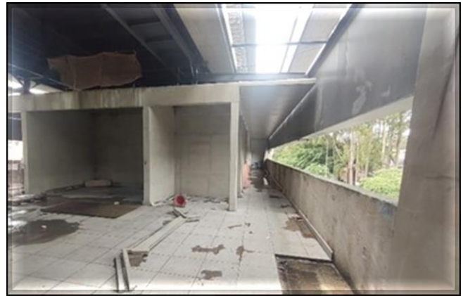
Acesso da Estação/ Obra Civil – Em andamento a contratação direta do escopo remanescente.
