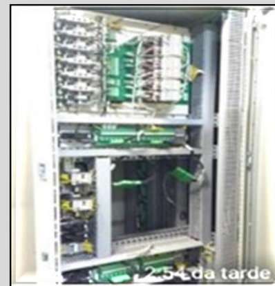
Gabinete de terminação de cabos
