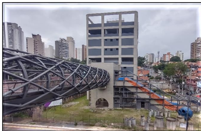
Obra Civil – Assinado o contrato em 31/08/2023 para a execução do escopo remanescente.
