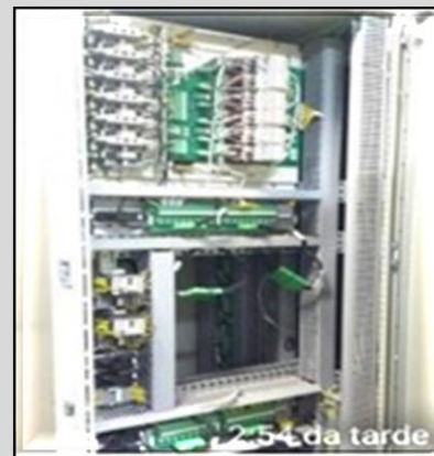
Gabinete de terminação de cabos
