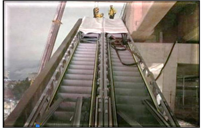
Obra Civil – Em andamento a contratação direta do escopo remanescente. Sistemas – Posicionamento das Escadas Rolantes.
