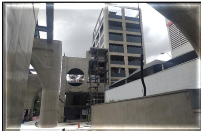
ETO e Acesso da Estação/ Obra Civil – Em andamento a contratação direta do escopo remanescente.
