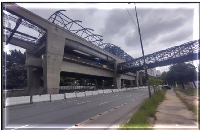
Corpo da Estação/ Obra Civil – Em andamento a contratação direta do escopo remanescente.
