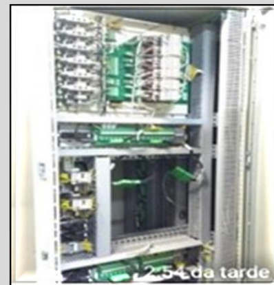
Gabinete de terminação de cabos
