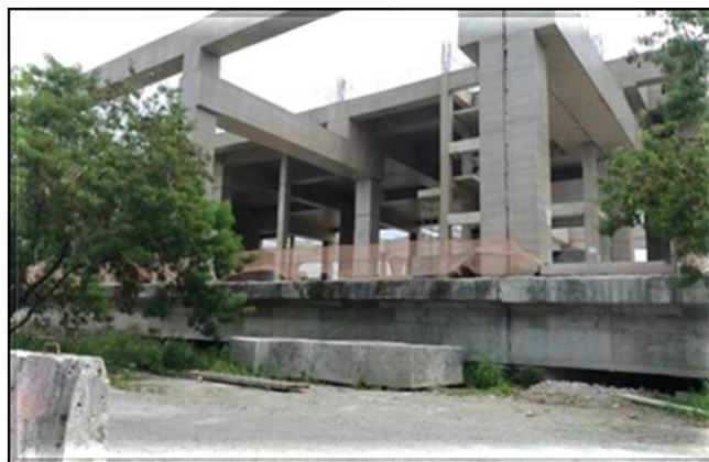
Bloco A/Obra Civil – Obra civil paralisada.
