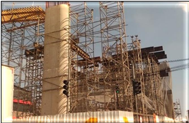
Obra Civil – execução das fundações, pilares e capitéis da via elevada, montagem do cimbramento da laje do Track Switch .
