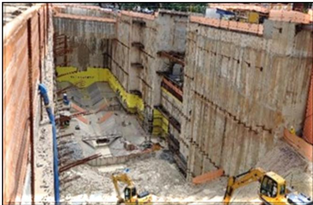
Escavação, tirantes e lastro da laje de fundo da vala do corpo da estação.
