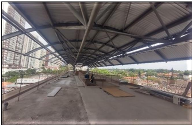
Corpo da Estação/ Obra Civil – Instalação das telhas da cobertura da plataforma.
