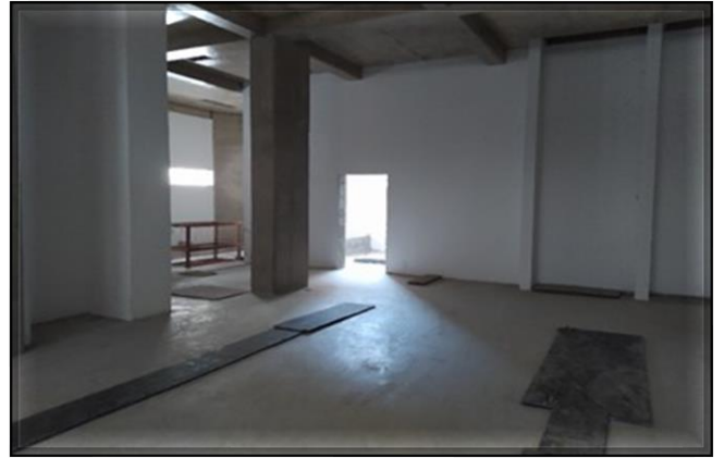
ETO/ Obra Civil – Executado acabamento com pendências.
