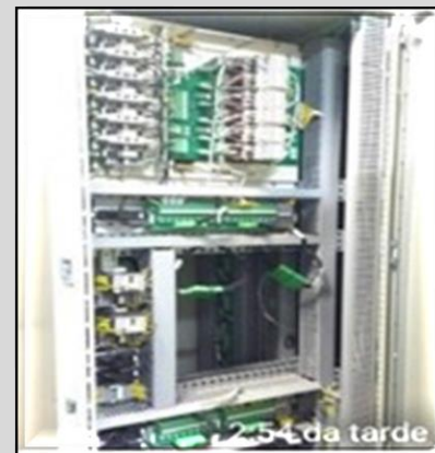
Gabinete de terminação de cabos
