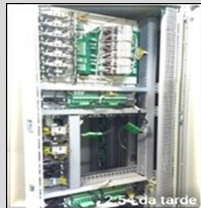
Gabinete de terminação de cabos
