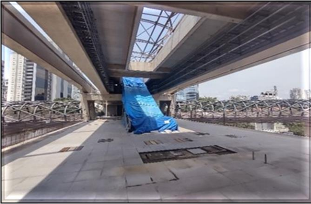
ETO/Obra Civil – Executado acabamento com pendências.
