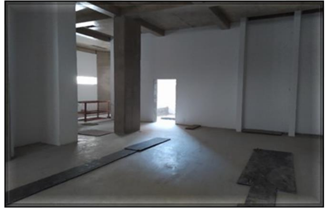
ETO/ Obra Civil – executado acabamento com pendências.
