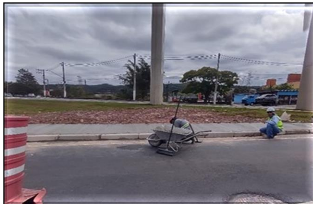
Obra Civil – Finalização do passeio. Sistemas – Em andamento os testes com os trens.
