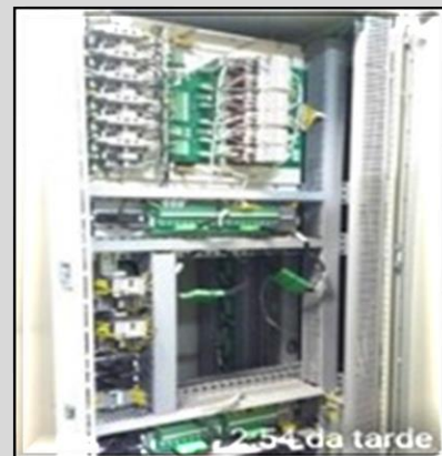
Gabinete de terminação de cabos
