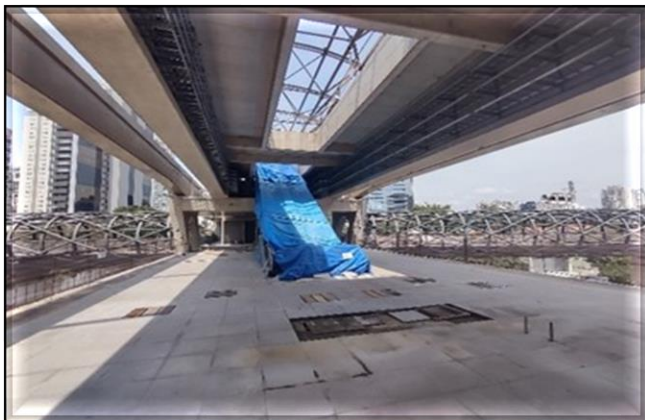
Corpo da Estação/Obra Civil – Piso de granito executado com pendências.
