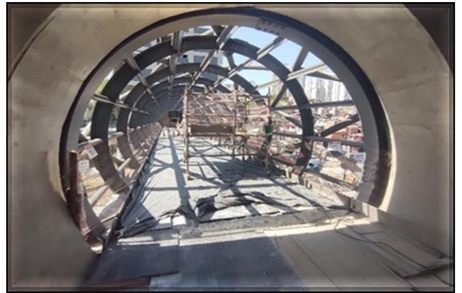
Corpo da Estação/ Obra Civil – Execução da marcação e furação para instalação dos suportes dos vidros.
