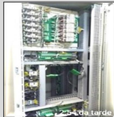
Gabinete de terminação de cabos
