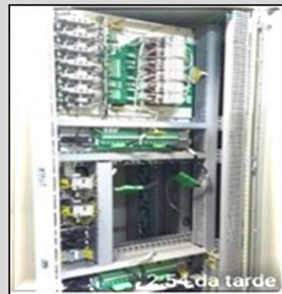
Gabinete de terminação de cabos
