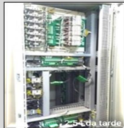
Gabinete de terminação de cabos
