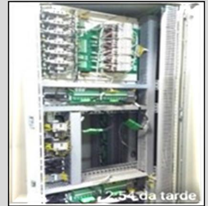
Gabinete de terminação de cabos
