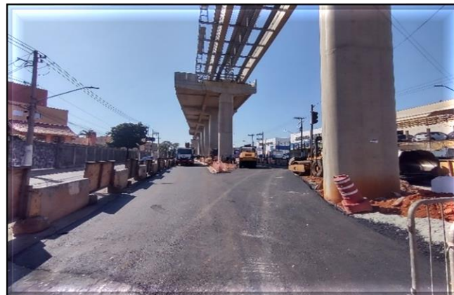
Obra Civil – Recomposição do viário. Sistemas – Montagem do bandejamento e passarela de emergência
