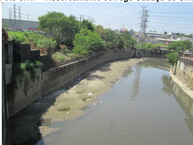
Foto 9.1.7 – Assoreamento córrego Cabuçu de Cima
