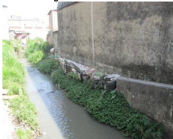
Foto 9.1.6 – Solapamento de margem no curso d'água da Vila Antonieta
