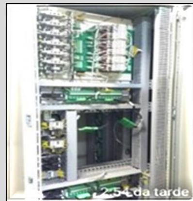
Gabinete de terminação de cabos
