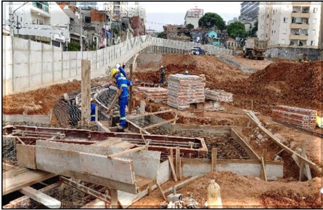
Viga guia para execução da parede de diafragma dos poços do corpo da estação.
