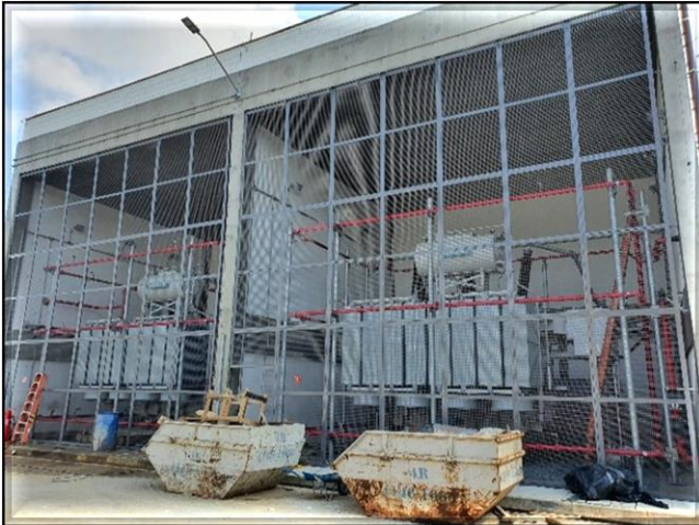
Obra Civil – em execução o fechamento dos nichos dos transformadores de alta tensão.
