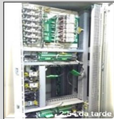
Gabinete de terminação de cabos
