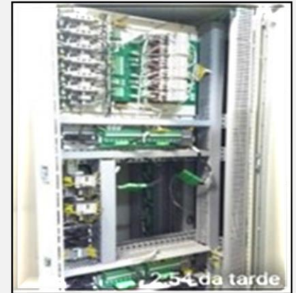
Gabinete de terminação de cabos
