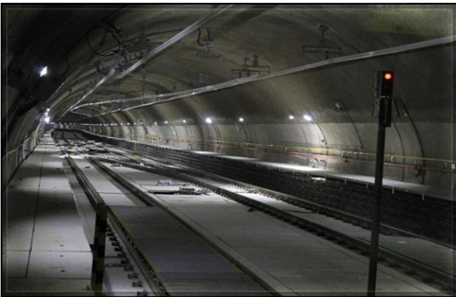
Túnel de Via – Sistemas em fase de retirada de pendências.
