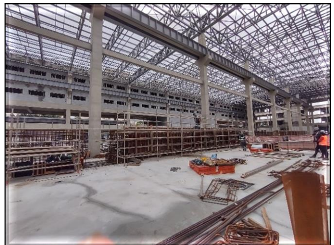
Bloco A – execução das vias internas e instalação das telhas da cobertura.
