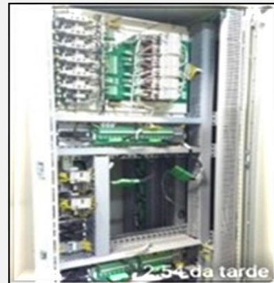
Gabinete de terminação de cabos
