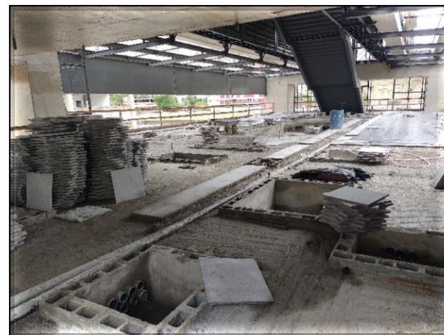
Corpo da estação – execução do piso de granito no mezanino de área paga.
