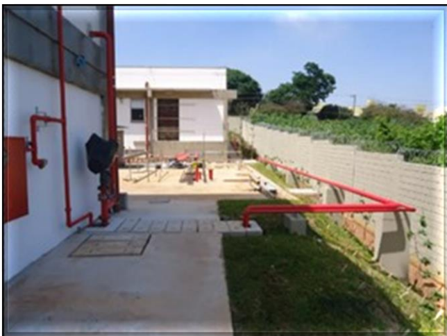
Obra Civil – em execução a montagem a tubulação de combate a incêndio
