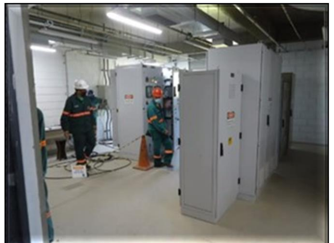
Sistemas – montagens e testes na sala de comando.
