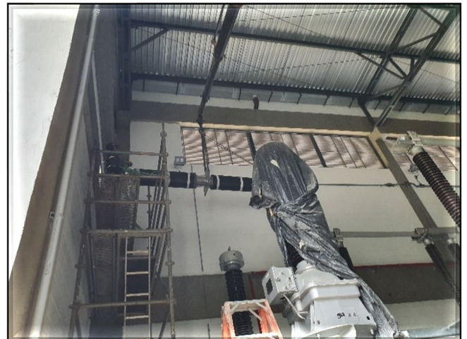
Sistemas – montagem da bucha de entrada da sala de alta tensão
