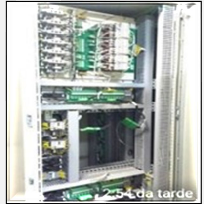
Gabinete de terminação de cabos
