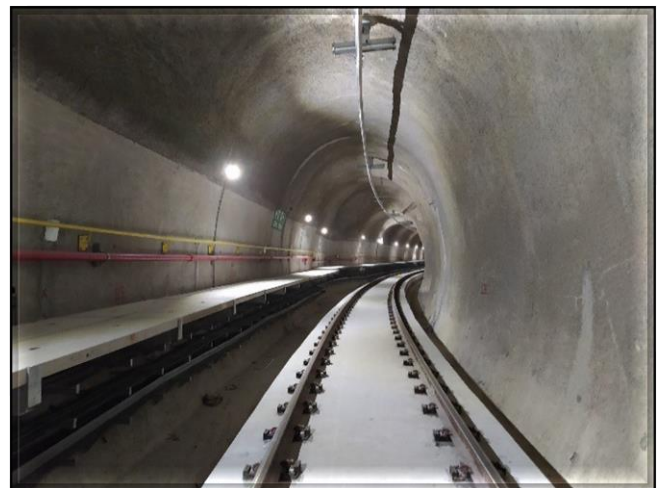
Túnel NATM Singelo – bandejamento com aterramento executado, iluminação do túnel em reposição; ajustes e comissionamento da Rede Aérea e da Tração em execução.
