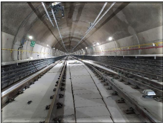
Túnel de Via 02 – ajustes e comissionamento da Rede Aérea e da Tração em execução.
